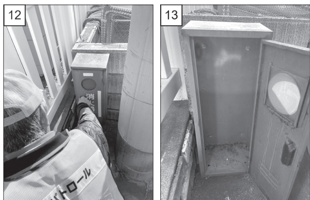
図1 消火器紛失が発覚した瞬間の写真
