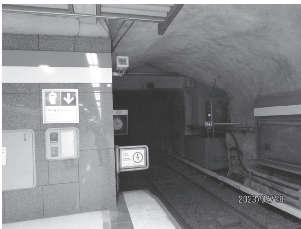
写真4 b 気密扉（トンネル側）
